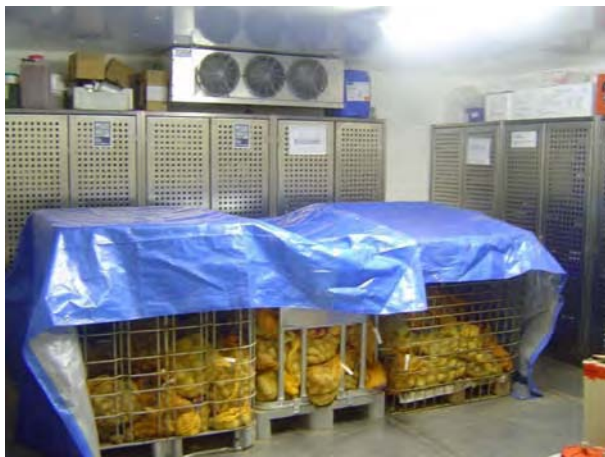
Abbildung 5: Kühllager im ttz Bremerhaven
